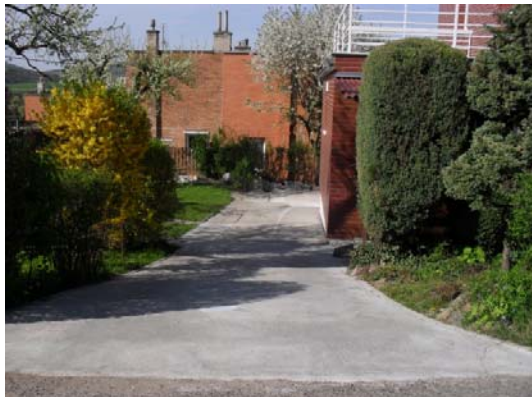
Obr. č. 68: Dokonale zpevnění, špatně vyspárovaný příjezd
