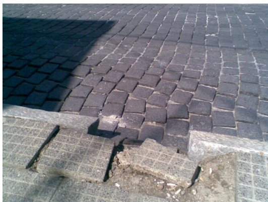
Obr. č. 34: Ul. Mostní, stav chodníku a vozovky
