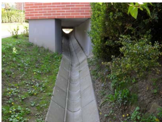
Obr. č. 80: Neobvyklé řešení svodu povrchové vody vedené pod samotnou stavbou
