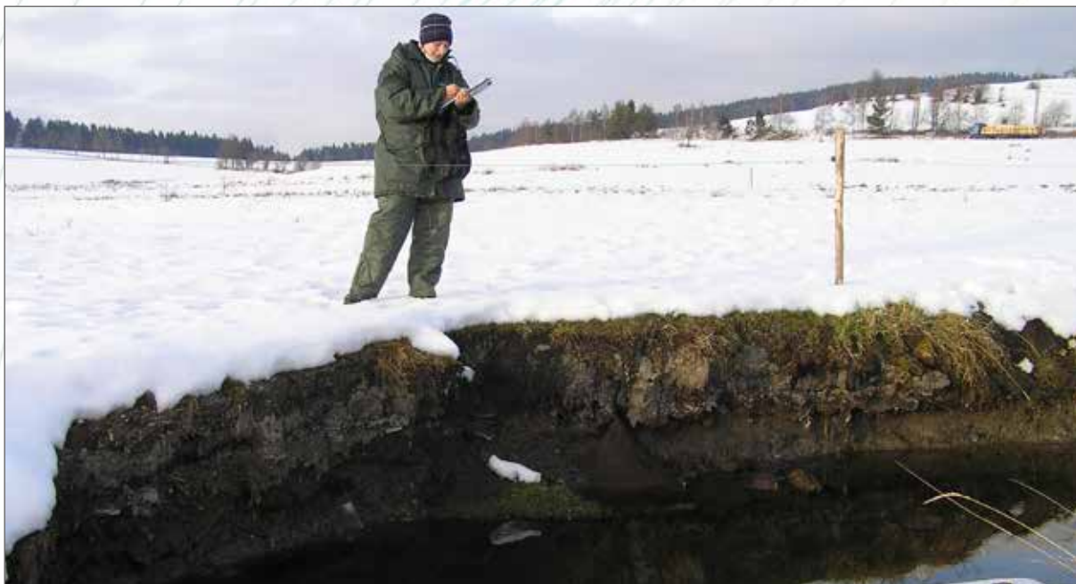
Obr. 196. Stav ohybu „D-a“ v prosinci 2005, kdy již byly zaznamenány masivní vnosy písku do hlavního toku Blanice. Jako řešení byly navrženy haťošterkové oživené válce.
