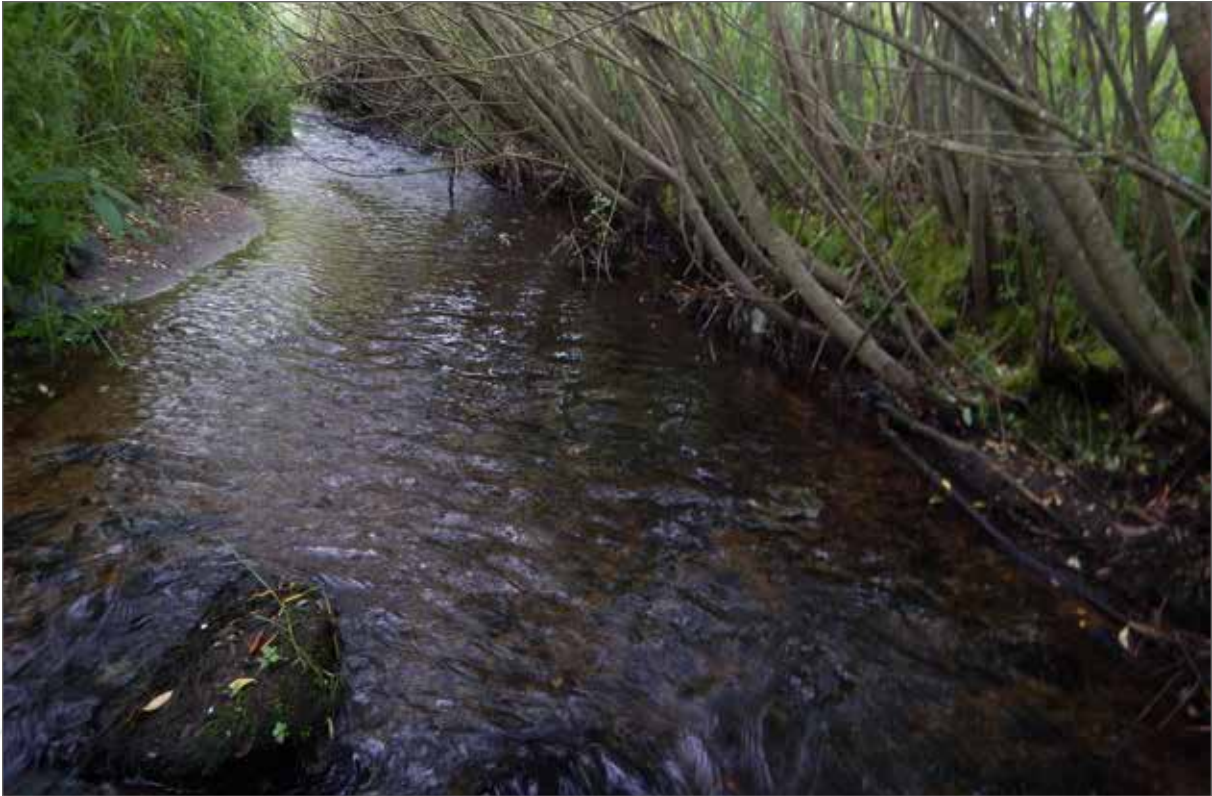
Obr. 152a. Příklad haťošterkových válců nevyžadujících údržbu. Stav oživených haťošterkových válců 10 let po založení (800 m n. m.), čistý průtočný profil, mladé kmínky se drží vzpřímeně.
