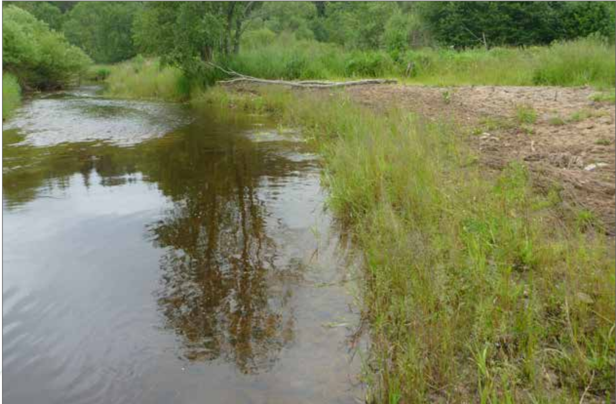
Obr. 158a. Zpevnění meandru pod elektrovedem na hlavním toku Blanice nad kolonií perlorodek. Pohled na stabilizovaný meandr (jaro 2016).
