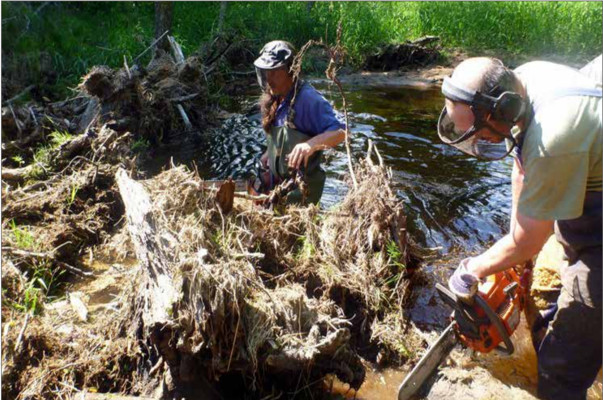
Obr. 156a. Příklad zprůchodňování vodotečí. Odstraňování zátarasu, ohrožujícího cenný meandr nad Odchovnou Spálenec.
