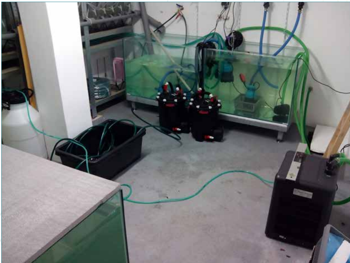
Obr. 35a. Odchovné zařízení pro ryby. Recirkulační odchovný systém sestavený K. Doudou v rámci řešení projektu OPŽP „Soužití člověka a perlorodky ve Vltavském luhu“, využívaný Správou NP Šumava k odchovům perlorodek.
