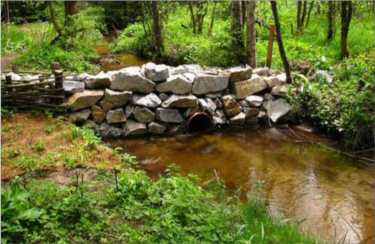
Obr. 147a. Technická realizace opatření na Lučním potoce v povodí Zlatého potoka. Rozliv těsně po dokončení stavby (zřetelná je plastová trubka převádějící celý běžný průtok a využití kokosových rohoží).
