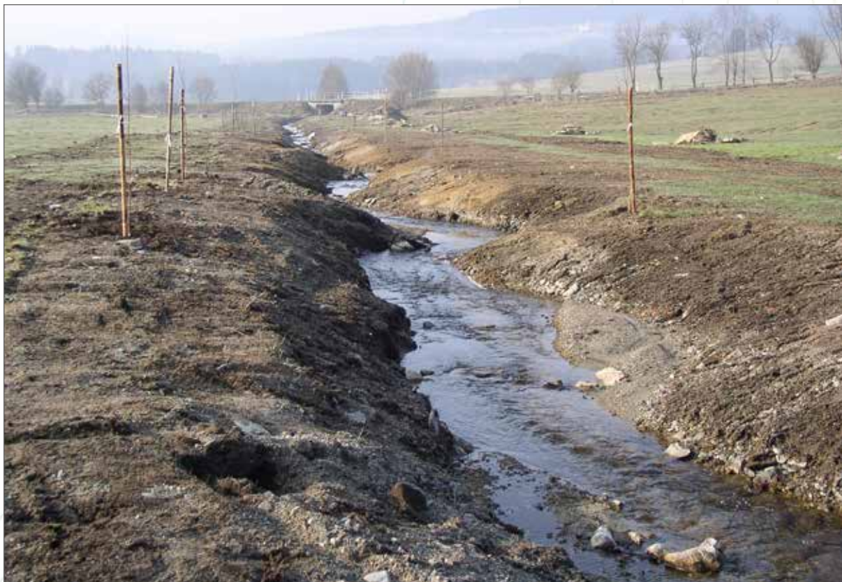
Obr. 151a. Průběh revitalizace na Zbytinském potoce. Vytrhání celoplošných panelů a ponechání nepřírodně zahloubeného koryta na podzim 2004 vedlo k nadměrnému vnosu splavenin do hlavního perlorodkového toku Blanice.
