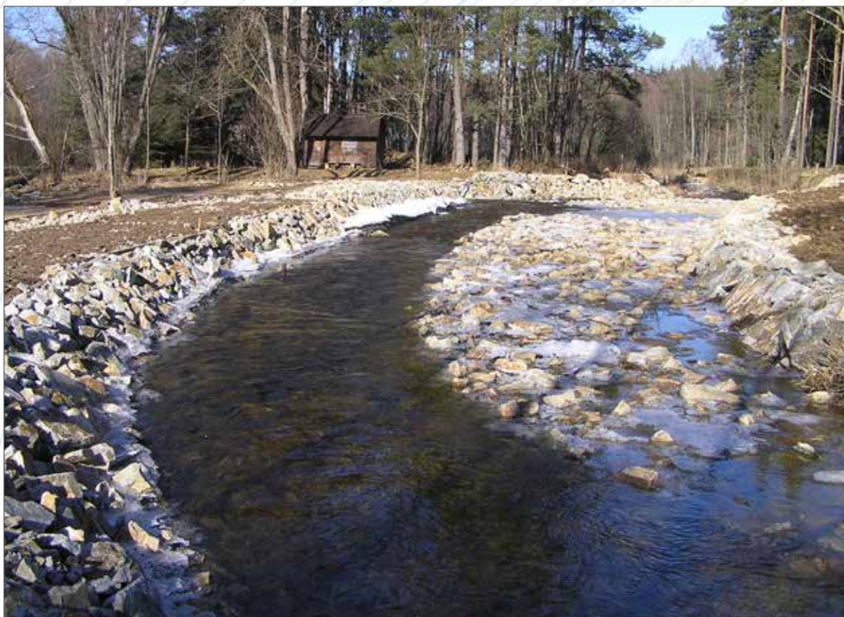
Obr. 155. Opevnění meandru z lomového kamene, provedené při nutné stabilizaci břehu nad příčným stupněm zavodňujícím boční rameno v místě ORP Odchovna Spálenec.
