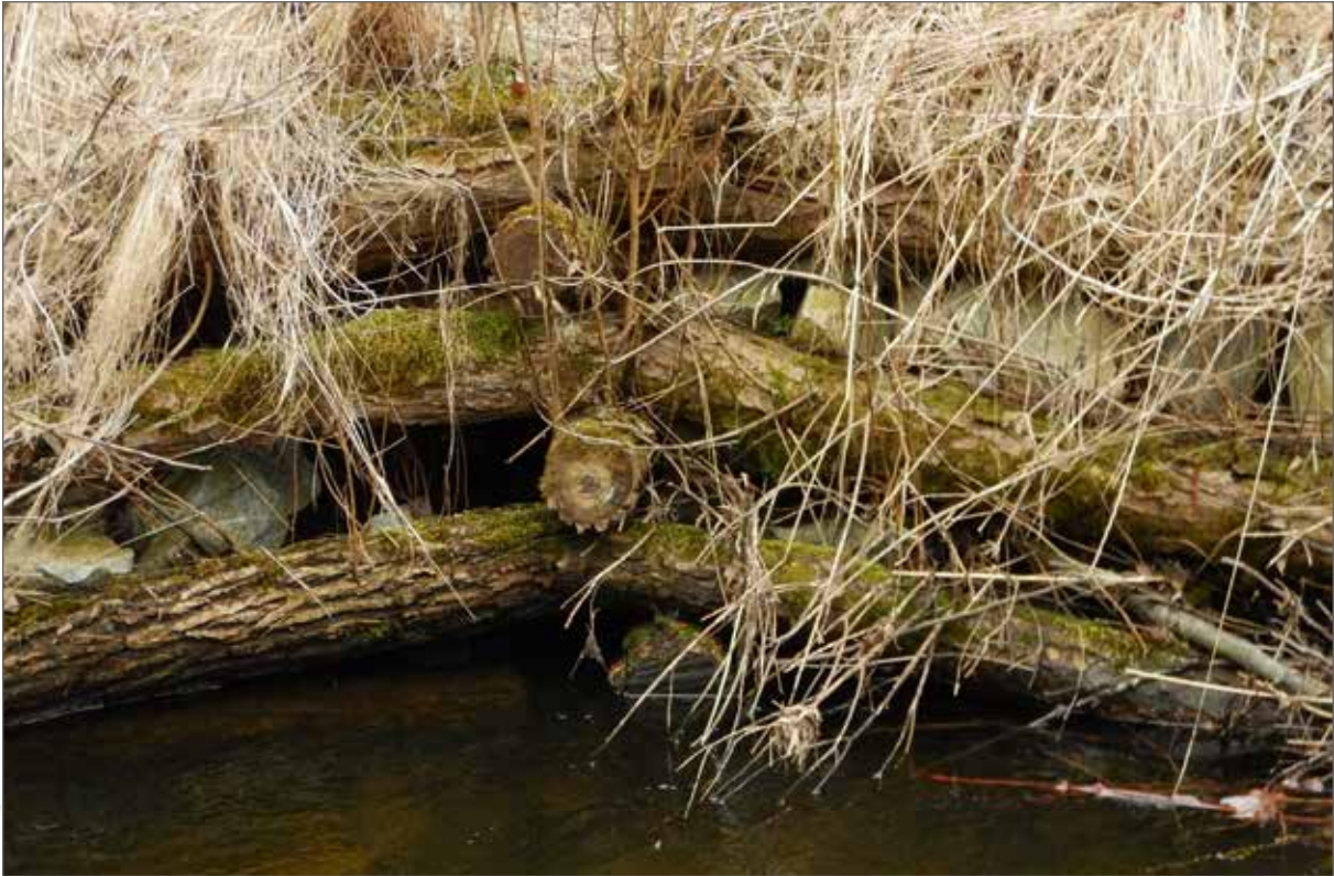
Obr. 154a. Živé srubové konstrukce z vrby. Detailní pohled na oživenou srubovou konstrukci z vrby v časném jaře – vrbové kmeny proložené lomovým kamenem.
